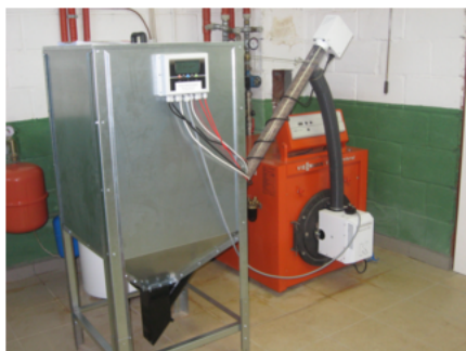
Kocioł Viessmann Vitola Comferral na olej opałowy po modernizacji z zamontowanym palnikiem na pelet Platinum Bio 16 kW.
