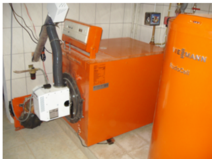
Kocioł Viessmann Vitola Comferral na olej opałowy po modernizacji z zamontowanym palnikiem na pelet Platinum Bio 24 kW.
